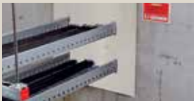
Cable tray, cables, conduits
